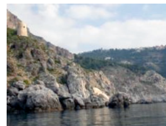
^ imagen 5.8. Bloques desprendidos del acantilado
